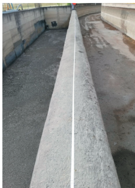
Manufatto di sfioro del Canale Adduttore del Tavoliere in corrispondenza dell'arrivo a Vasca Tavoliere (Fonte: relazione progettuale)
