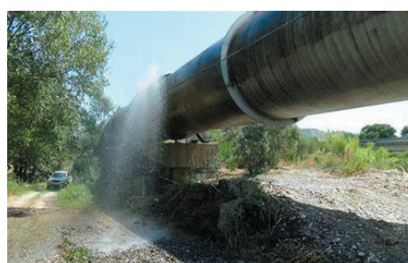
Perdita localizzata della condotta (Fonte: web)
